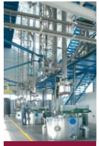
Autoclave Procédé Diamant® Chargement et vidange du granulé par voie pneumatique (aspiration et soufflage) en ambiance étanche
